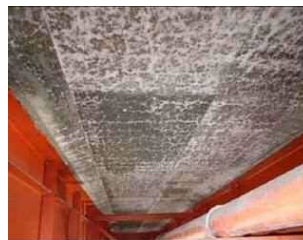
未対策による劣化促進
