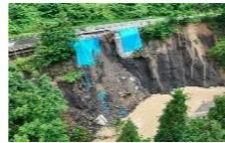
R4 8月の国道121号道路路面崩落 （現在は仮設道路による片側交互通行）
