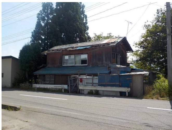
周辺に危険を及ぼすおそれのある空き家
