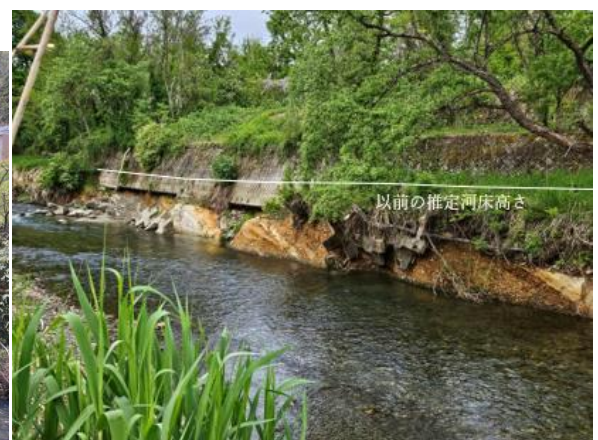
河床低下による護岸等への影響が懸念される鬼面川
