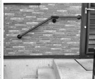
▲住宅の出入口に設置された手すり
