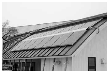
▲太陽光発電の設置状況は
