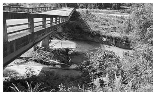
▲8月3日の豪雨で損壊した上屋敷橋
