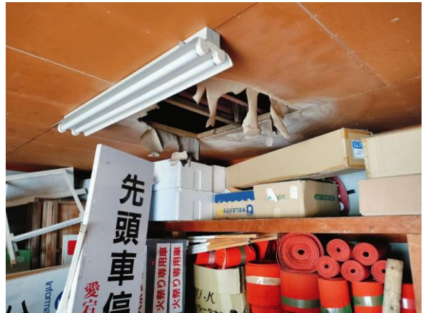
万世片子車庫：天井の欠損（穴）
