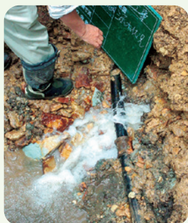
水道管の漏水の様子
