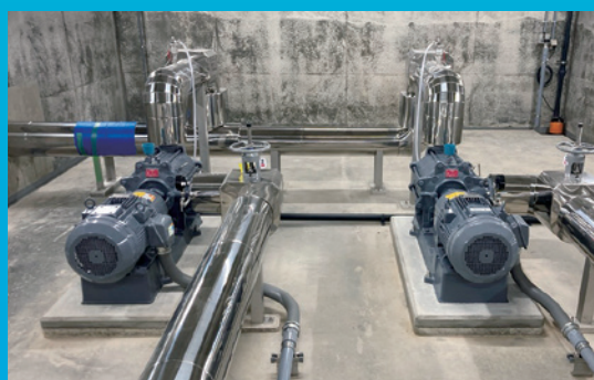
（赤芝配水池↓小野川配水池） 送水ポンプ
