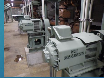
既設汚泥ポンプ
