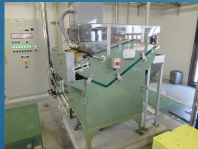
汚泥濃縮装置
