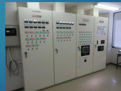
動力制御盤・計装盤
