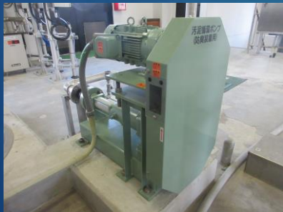
汚泥循環ポンプ
