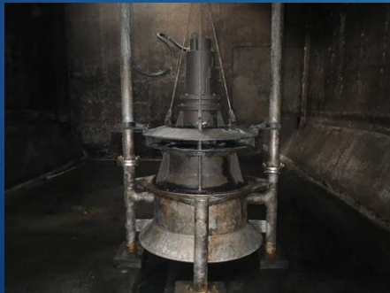
既設水中エアレーター
