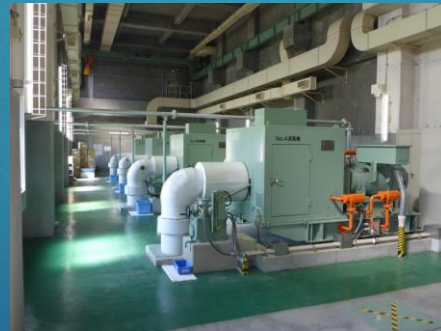
既設ブロー設備
