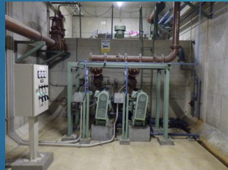
既設スカムピット設備
