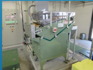
汚泥濃縮装置
