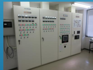
動力制御盤・計装盤
