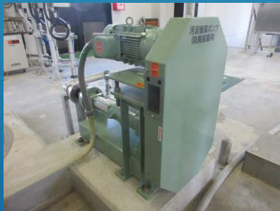
汚泥循環ポンプ
