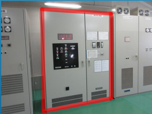
遠方監視制御設備の 更新(赤枠の部分)
