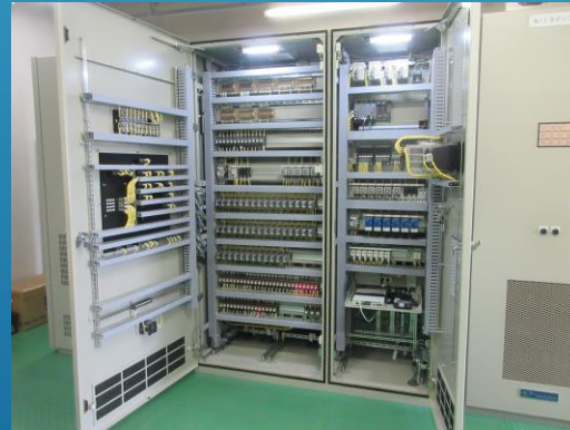
遠方監視制御設備の更 新(内部)
