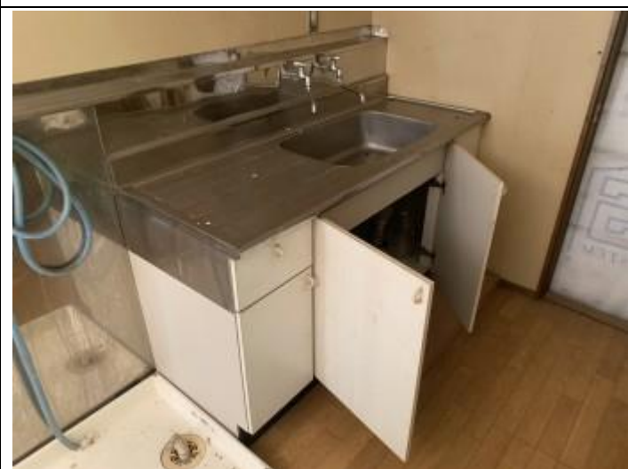
24 建物② 2階手洗い
