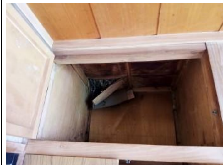
39 損傷 1 階北旧棟北六畳クローゼット上天袋 天井
