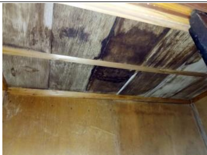
38 損傷 1 階旧棟南六畳押入シミ
