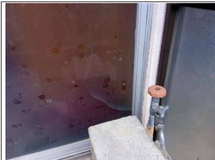
37 損傷 1 階サービスルームサッシ割
