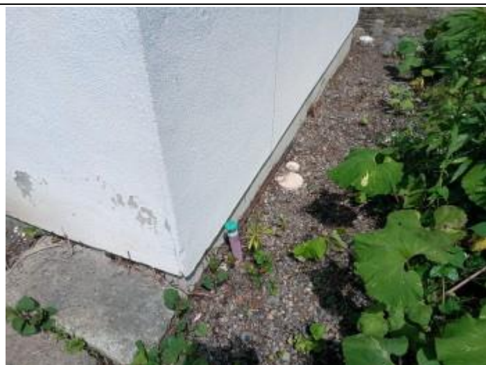
40 損傷ボイラー室外東元栓
