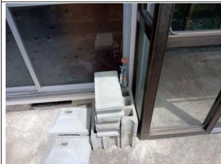
41 損傷玄関横 D 型水栓
