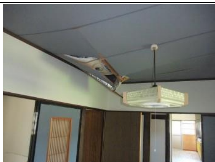
36 和室 2 天井破損
