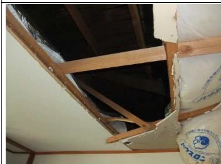
35 洋室 1 天井破損 2
