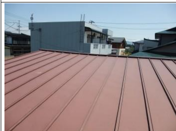
33 屋根棟木損傷
