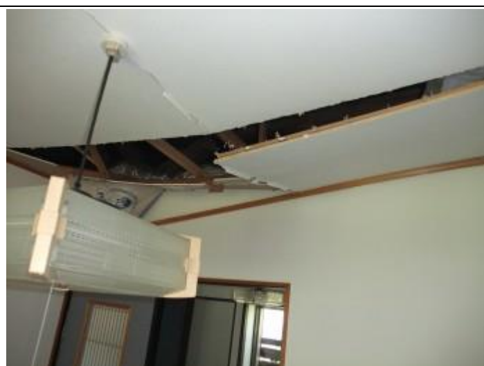
34 洋室 1 天井破損 1
