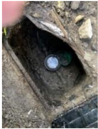
08 水道メーター
