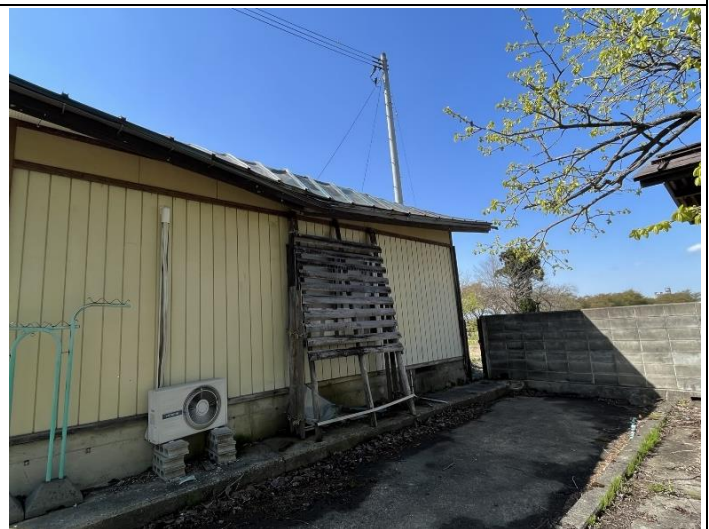
06 東側屋根破損箇所
