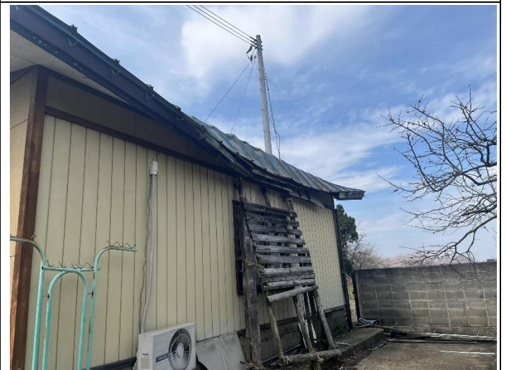
04 東側屋根破損箇所
