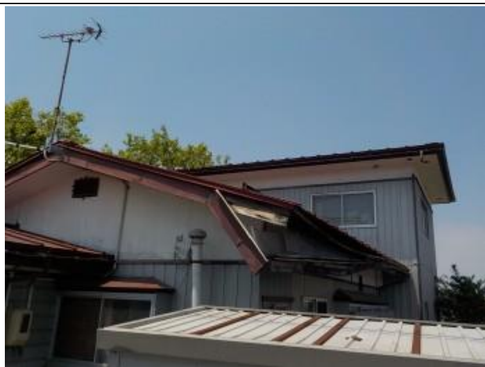
05 北側軒破損箇所
