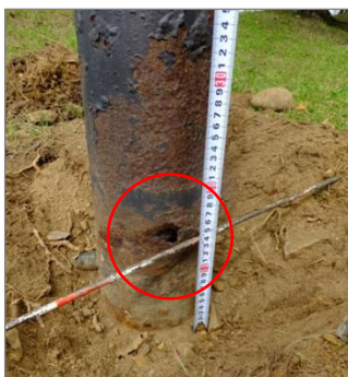
照明灯支柱の腐食
