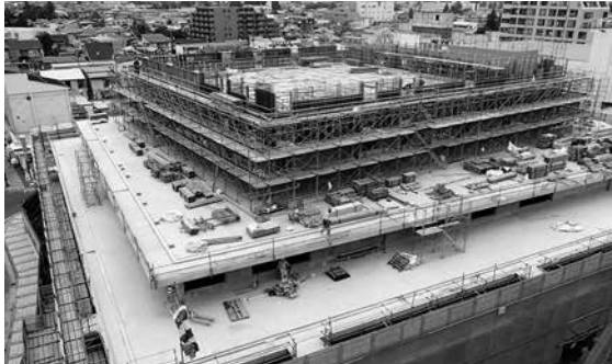
▲現在、5階（最上階）の躯体工事を行っており、10月中旬には天井のコンクリート打設が完了します。（8月11日撮影）
